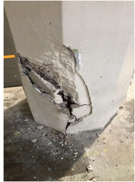
Ilustración 38. Columnas con grietas en la cancha
