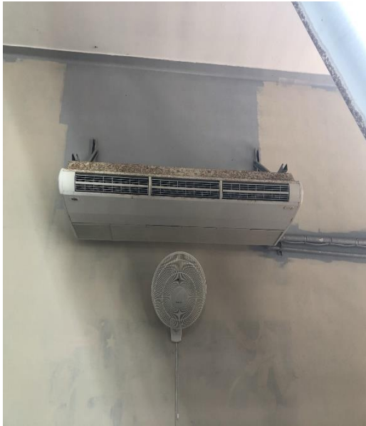
Ilustración 5. Aire de 5 tons. dañados
