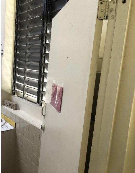
Ilustración 33. Reemplazar las puertas de maderas de los baños
