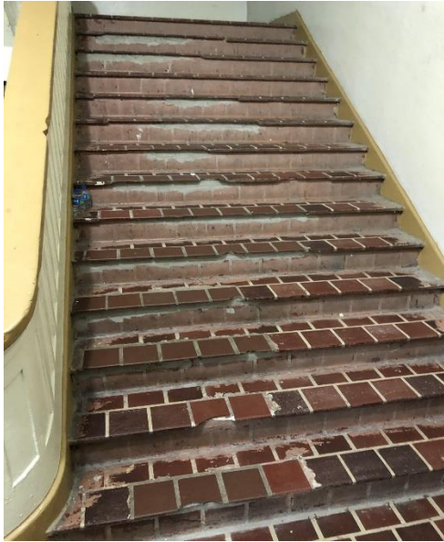
Ilustración 13. Arreglar los bordes de las escaleras
