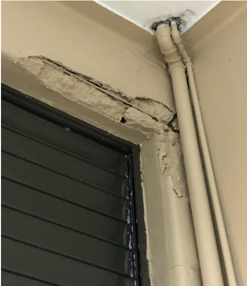
Ilustración 9. Empañetado de varilla expuesta salón 112
