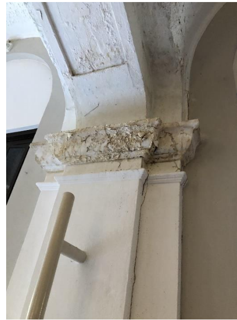
Ilustración 28. Filtraciones en el teatro
