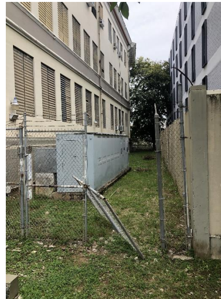
Ilustración 40. Realizar mantenimiento a la subestación
