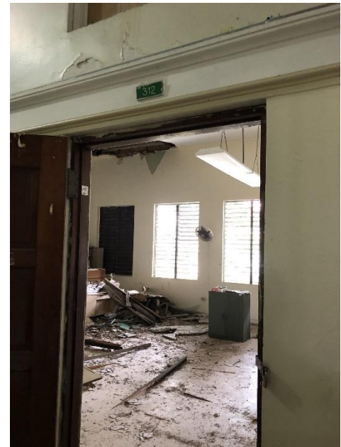
Ilustración 24. Techo del salón 312 colapso
