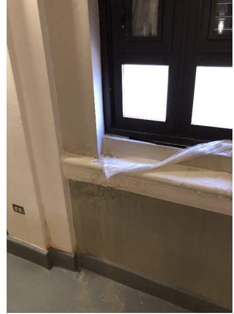
Ilustración 30. Filtraciones en el teatro
