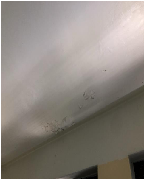
Ilustración 15. Filtración en plafón de madera acústico
