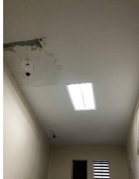
Ilustración 18. Filtraciones en los baños
