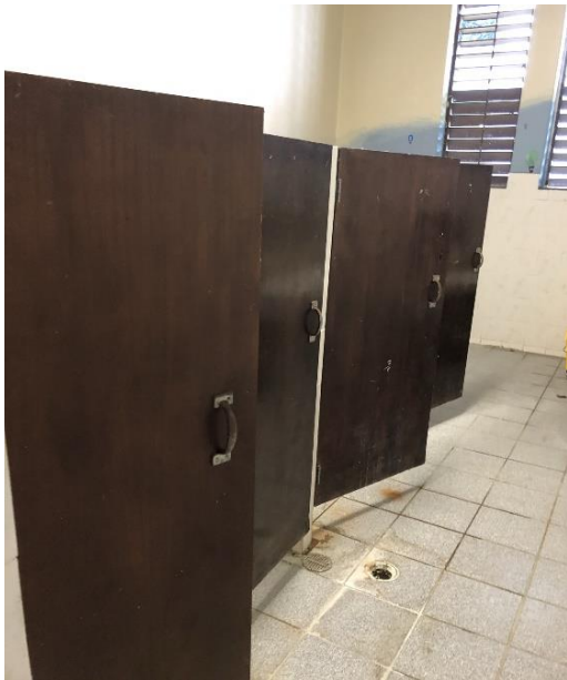
Ilustración 11. Reemplazar las puertas de los baños
