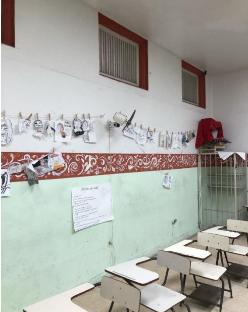
Ilustración 17. Falta de pintura
