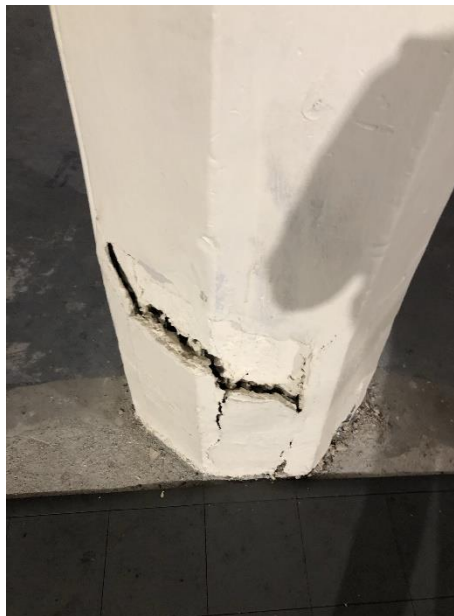
Ilustración 39. Columnas con grietas en la cancha
