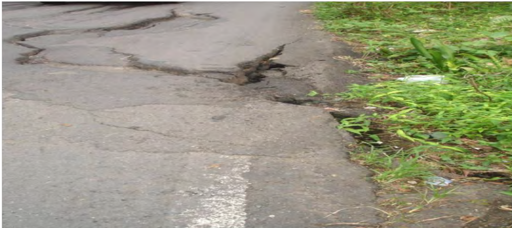
Grietas en la Carretera PR-146 2
