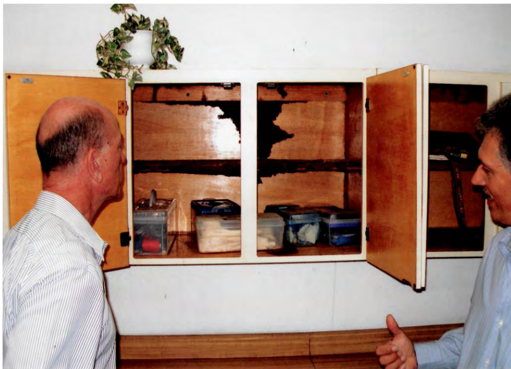
Problemas de comején en los gabinetes del Salón de Economía Doméstica
