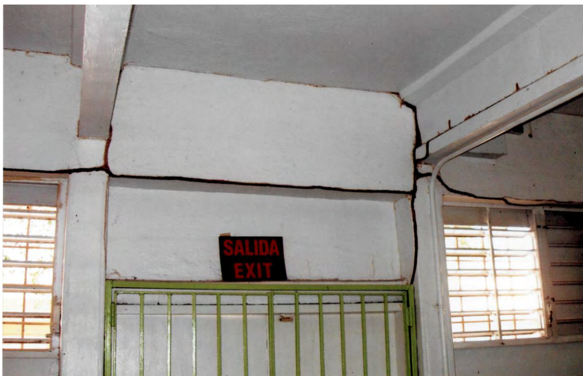
Problema de comején en las paredes del plantel escolar
