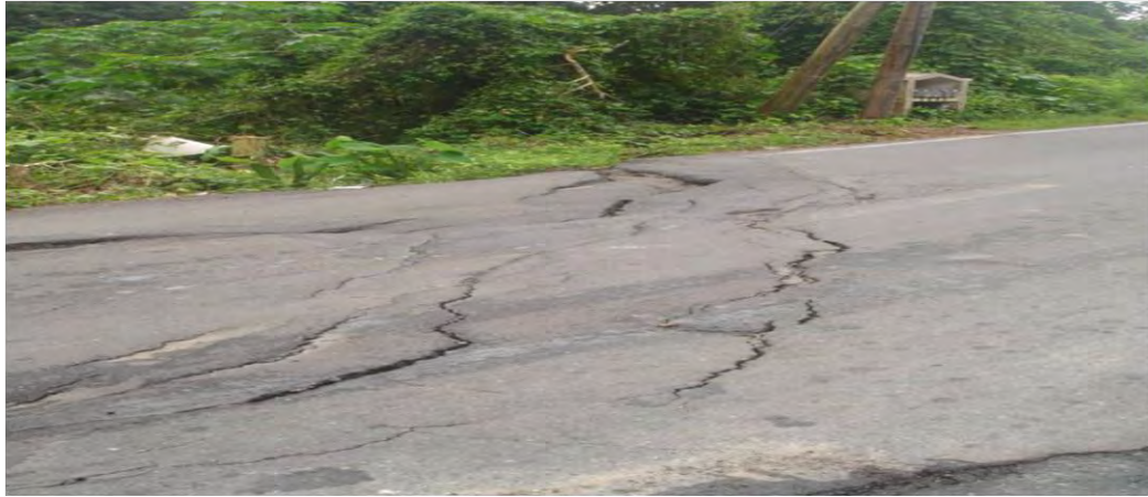
Grietas en la Carretera PR-146 1
