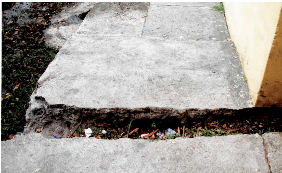
Serios problemas en las aceras de la escuela
