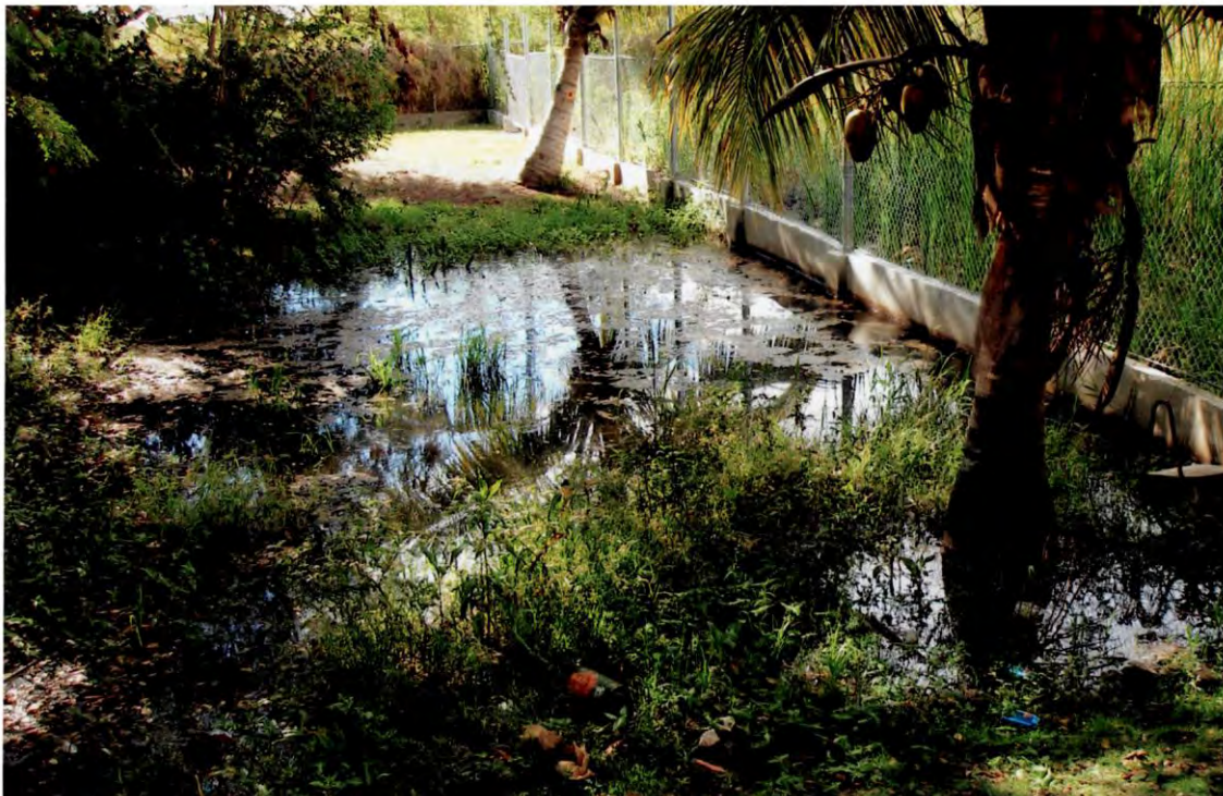
Estancamiento de aguas pluviales
